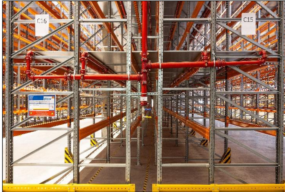
Regalsprinklerung mit Wärmestablechen
