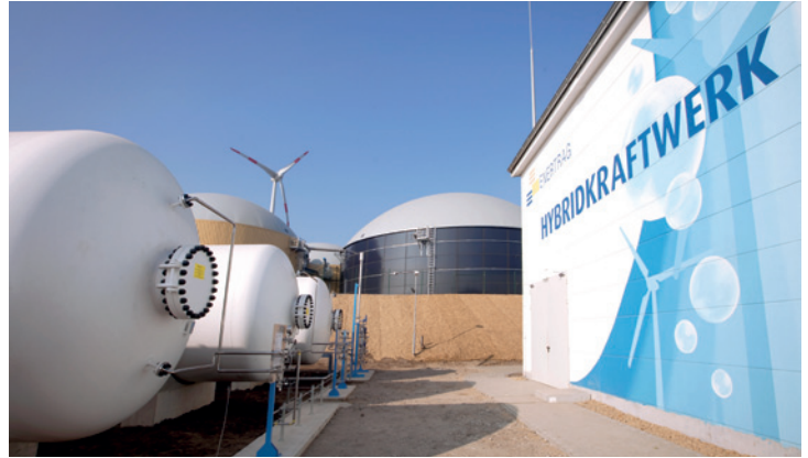
Hybridkraftwerk von ENERTRAG in Prenzlau
